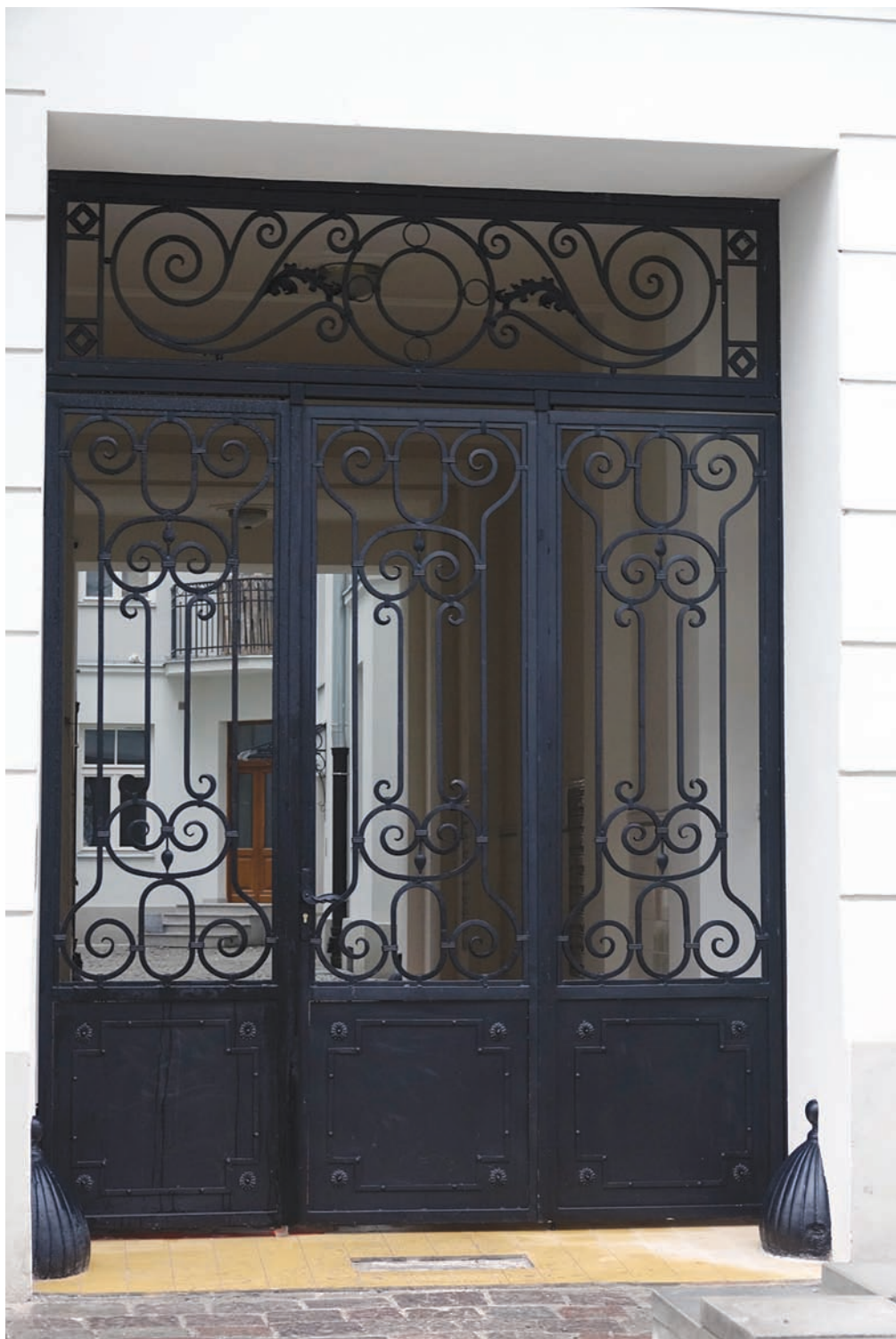
Ilustracja 17. Opracowane na bazie oryginalnego projektu z 1913 roku wrota bramne w kamienicy przy ulicy Jagiellońskiej 27 — stan w styczniu 2021 roku. Fot. P. Kilanowski
